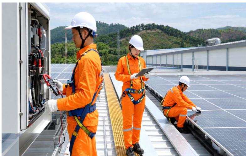
Điện lực Thái Nguyên kiểm tra hệ thống điện mặt trời mái nhà, bảo đảm vận hành an toàn, ổn định và hiệu quả
